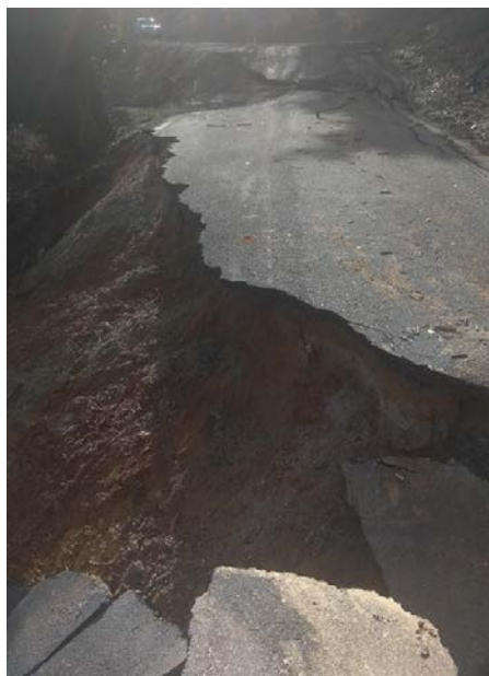
11.2.2019 Κατάρρευση οδικού επαρχιακού δικτύου στον Άγιο Πέτρο Αρκαδίας
